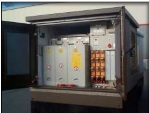
Transformatoren- und Schaltstationen
